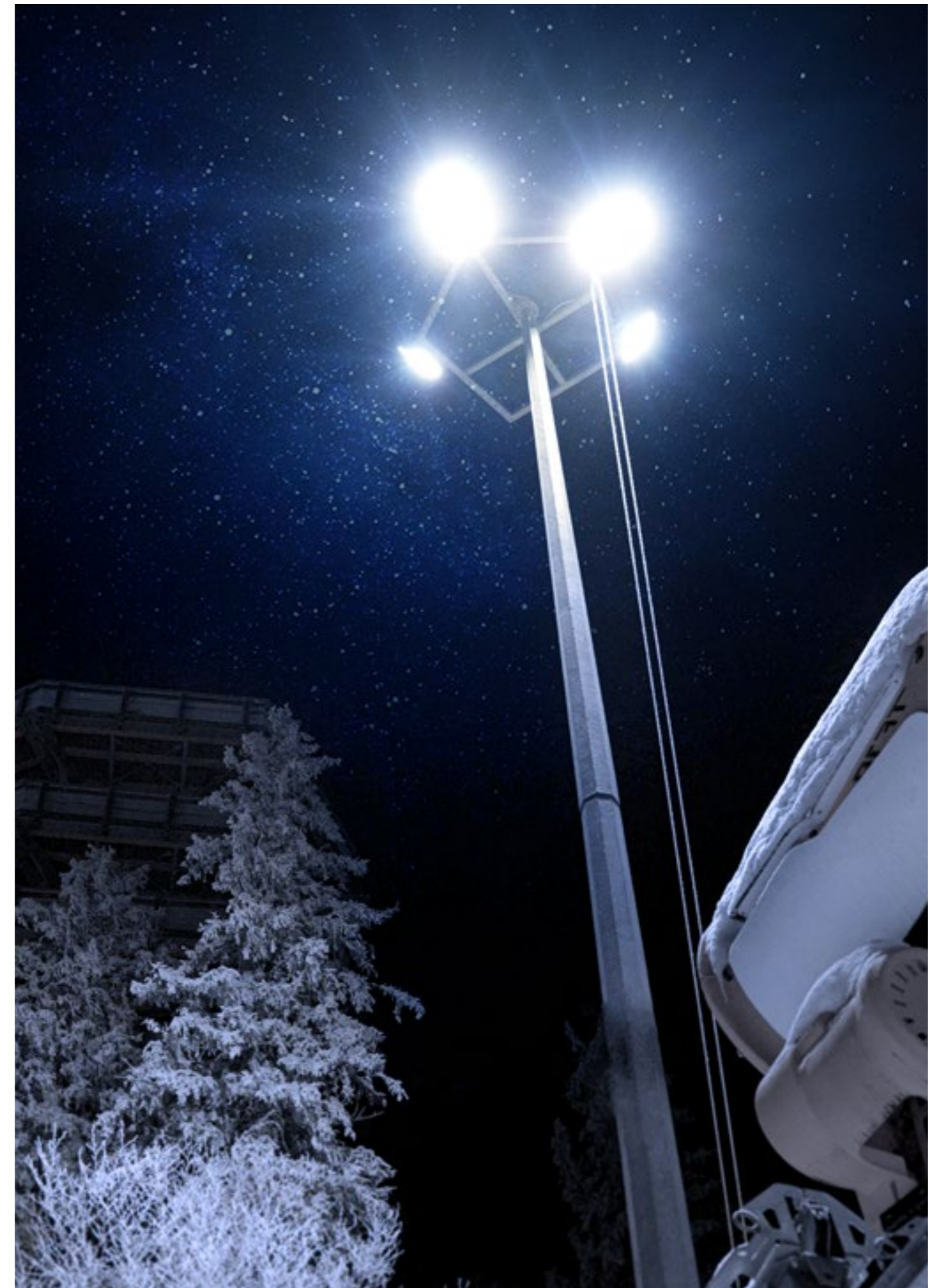
Beleuchtung der Skipiste Stotwiny Arena
