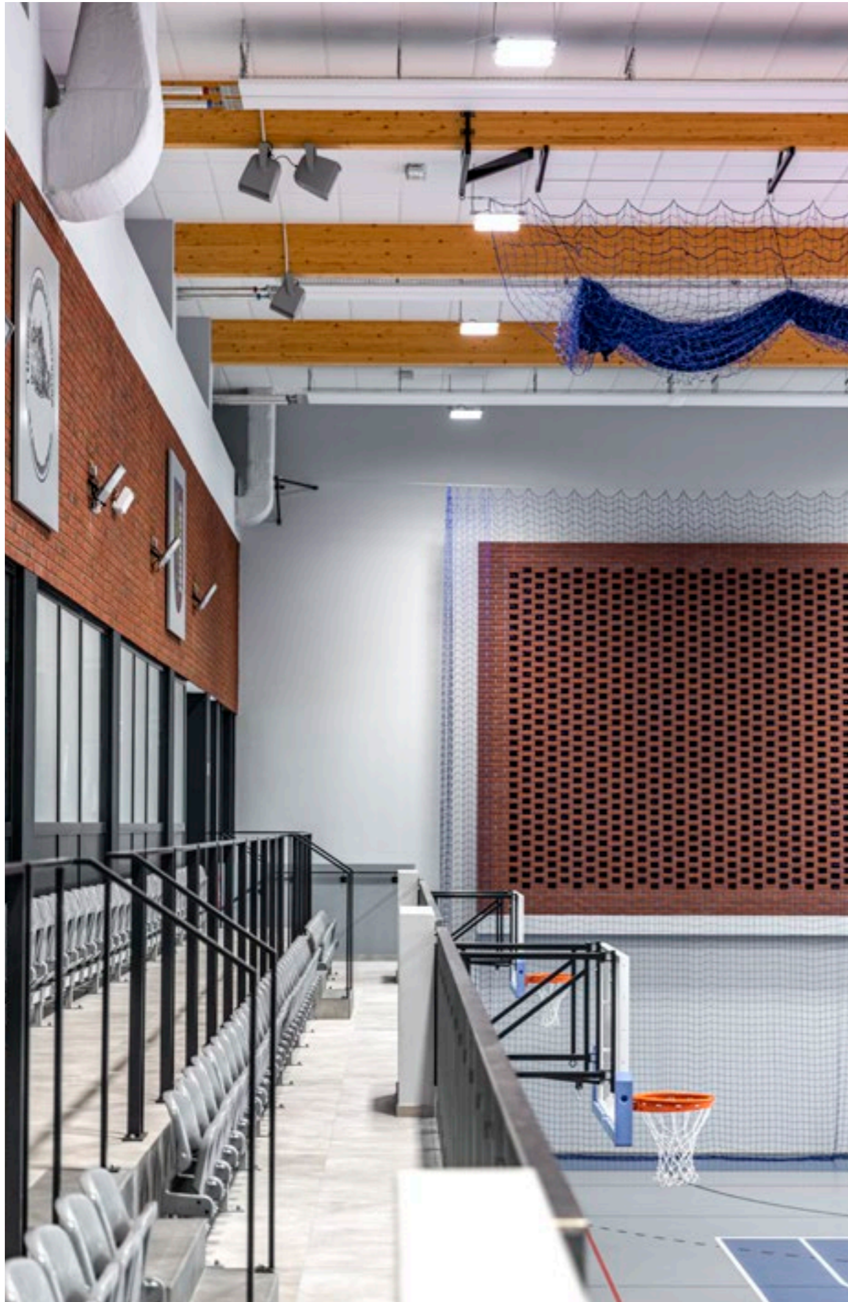
Beleuchtung der Sporthalle in Gliwice
