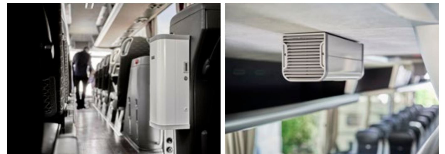
Einsatz der Sterilon Car UV-C-Lampen in Bussen von LuxSebTrans.
