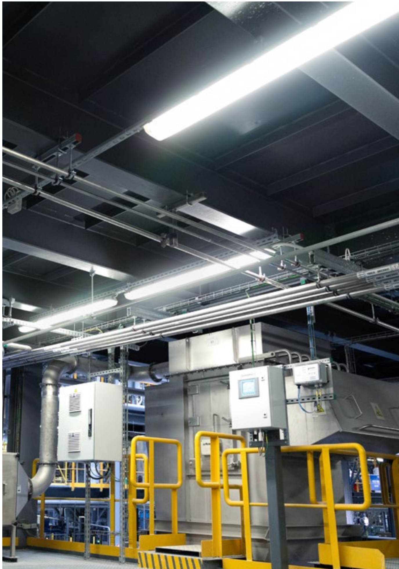
Einsatz von Tytan Multi LED Chemo Leuchten in einer Produktionshalle
